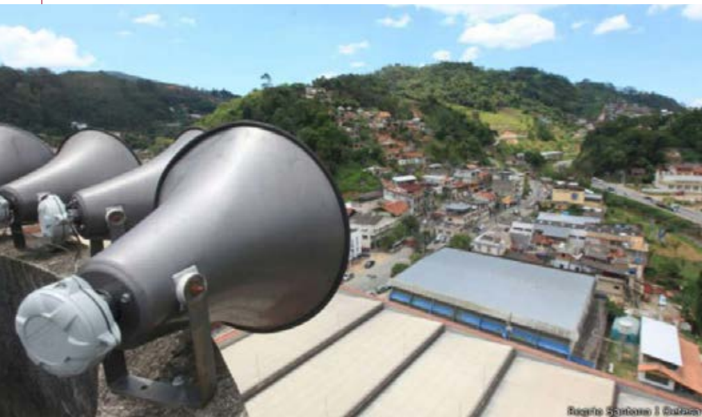
Programa estadual da Defesa Civil, criado no ano de 2011, aciona sirenes em comunidades: ações de prevenção reduzem perdas e danos provocados pelos deslizamentos de terra
